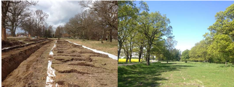
Figur 2.1:9. Exempel på ett kabelstråk under anläggningsskedet samt drygt 2 år efter anläggning.
